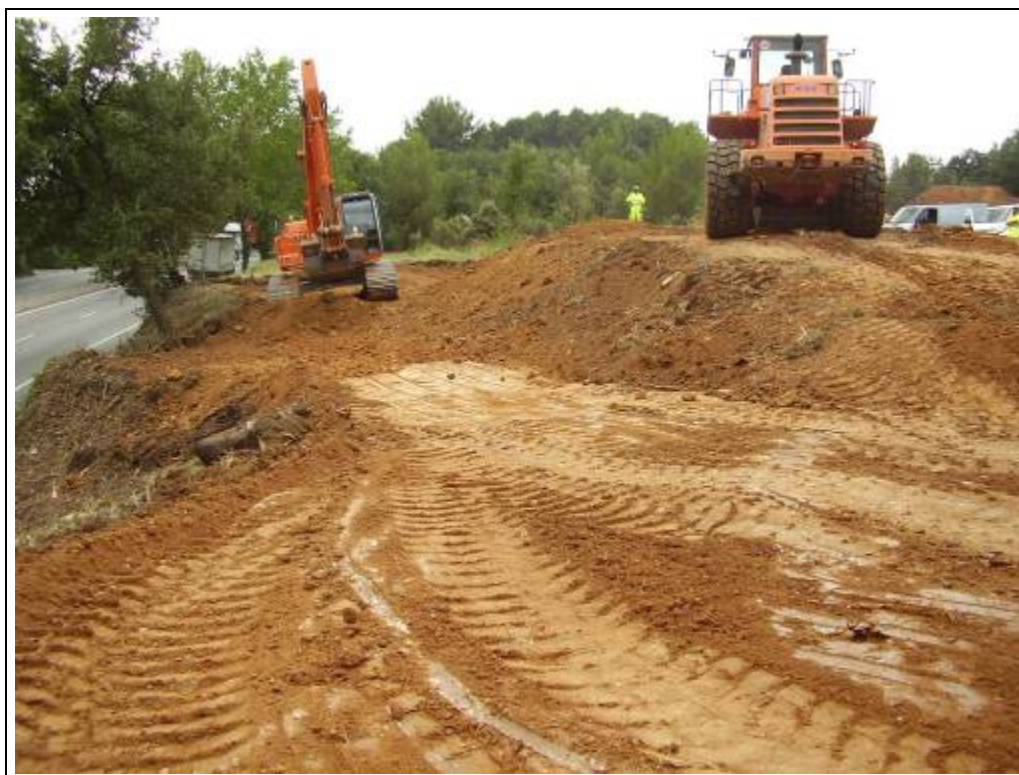
Foto 60: Àrea 2. Rebaixos a la zona d'expropiació. Direcció sud
