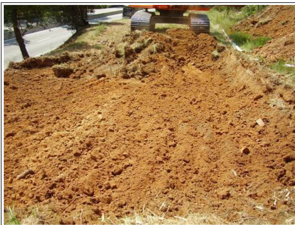
Foto 58: Àrea 2. Rebaixos a la zona d'expropiació. Direcció sud
