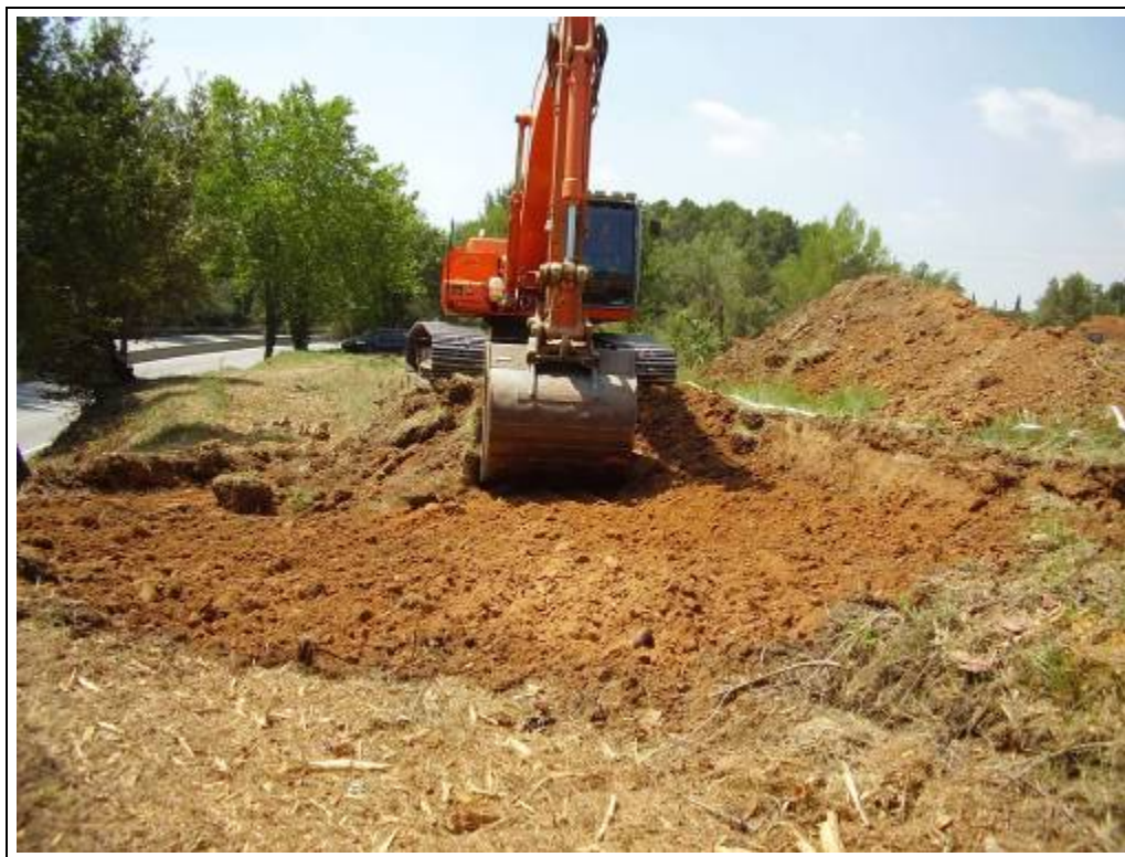
Foto 59: Àrea 2. Rebaixos a la zona d'expropiació. Direcció sud
