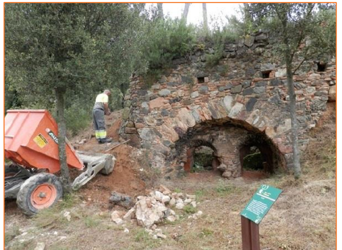
Fig. 4. Treballs de recuperació del forn d'obra de ca l'Oliveró (La Garriga). Extret de:
