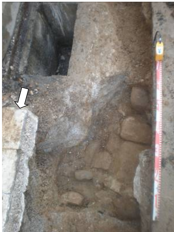
Foto 4: Segment central del mur UE 6 amb afectació d'embornal UE 10
