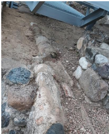
Canalització propera a la claveguera
